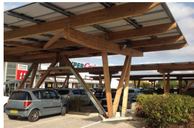
Ombrières Saint-Pierre-lès-Nemours (77) 1250 m2
